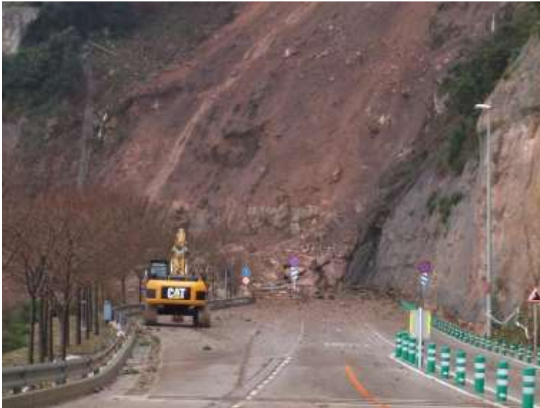
Carretera d'accés a Montserrat tallada per la caiguda de grans roques
