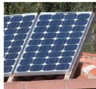
Un panell solar, format per 36 cèl·lules connectades en sèrie, instal·lat a la teulada d'una casa.
